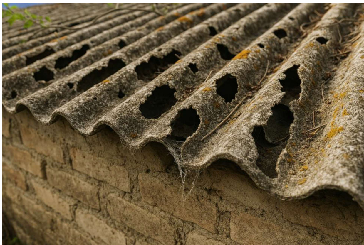
Figura 31 - materiale contenente amianto in copertura, originariamente compatto, degradato a tal punto da essere diventato fonte di cospicuo rilascio di fibre
