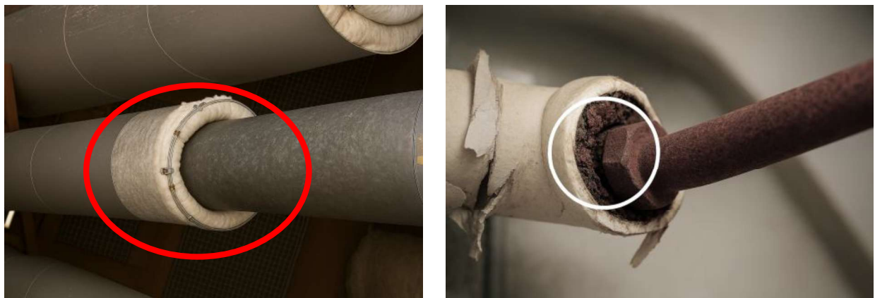
Figure 17 - coibentazione di tubi con stuoia di amianto (sx) e malta con amianto (dx)
