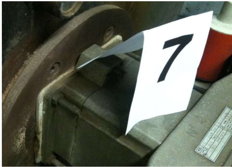
Figura 34 - guarnizione locale caldaia
