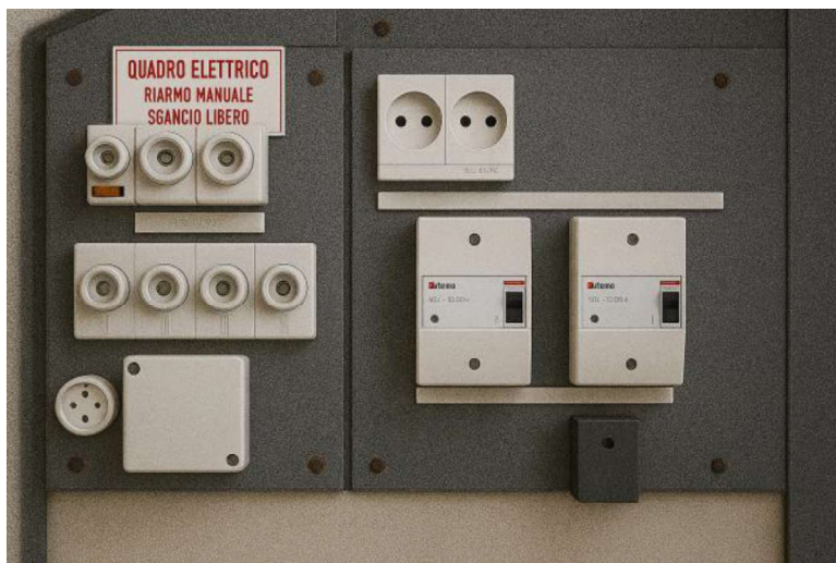
Figura 8 - quadro elettrico con lastre in cemento-amianto
