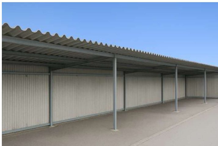
Figura 7 - pensilina in cemento-amianto
